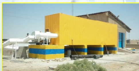
سیستم کنترل و حذف بو (بیوفیلتراسیون) ایستگاه پمپاژ فاضلاب شماره ۱ شهر قم
